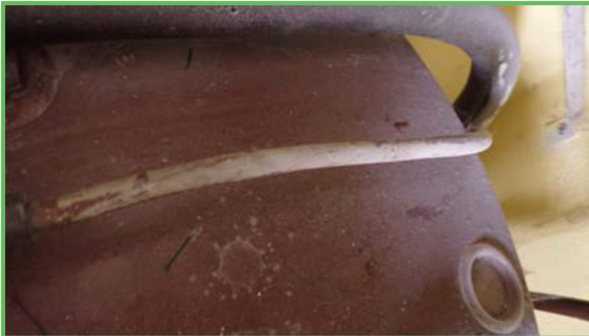
TPR Discharge Pipe
