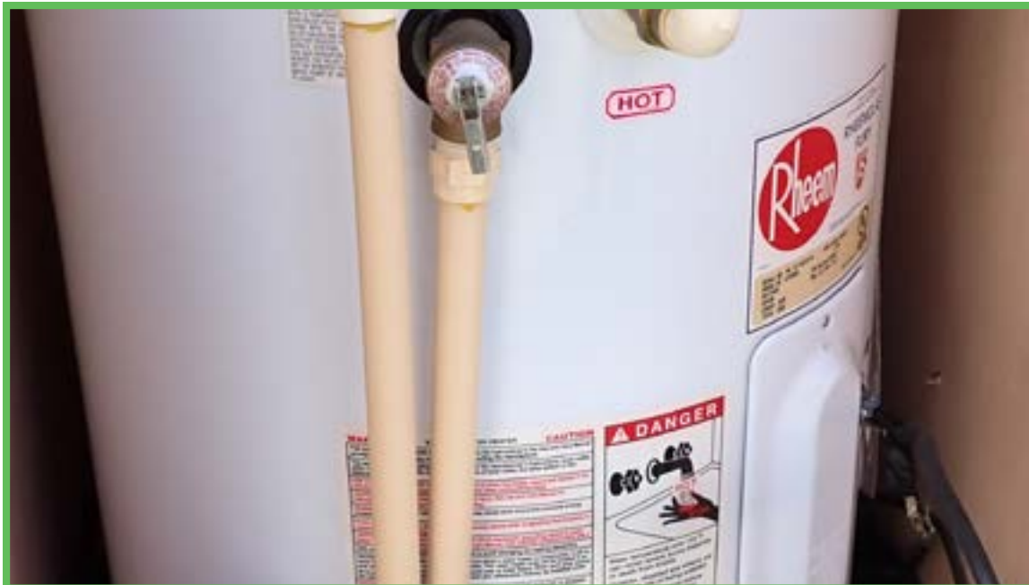
TPR Discharge Pipe
