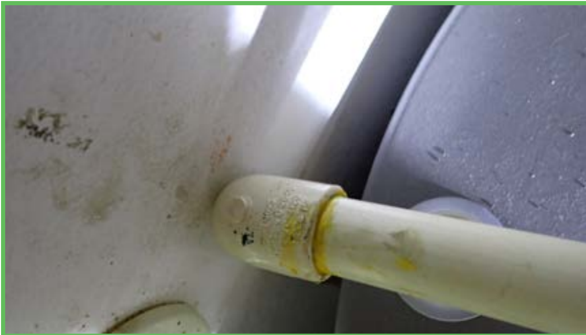
TPR Discharge Pipe
