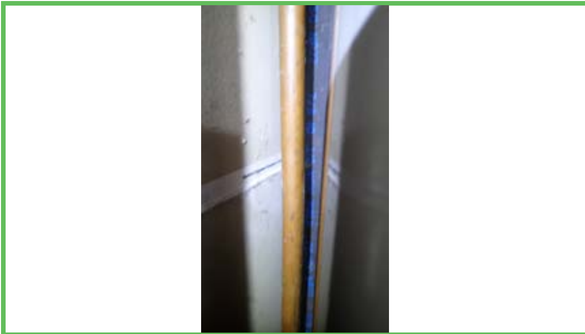
TPR Discharge Pipe
