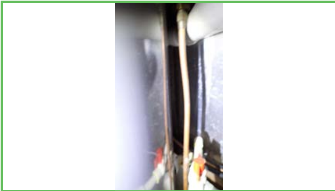
TPR Discharge Pipe
