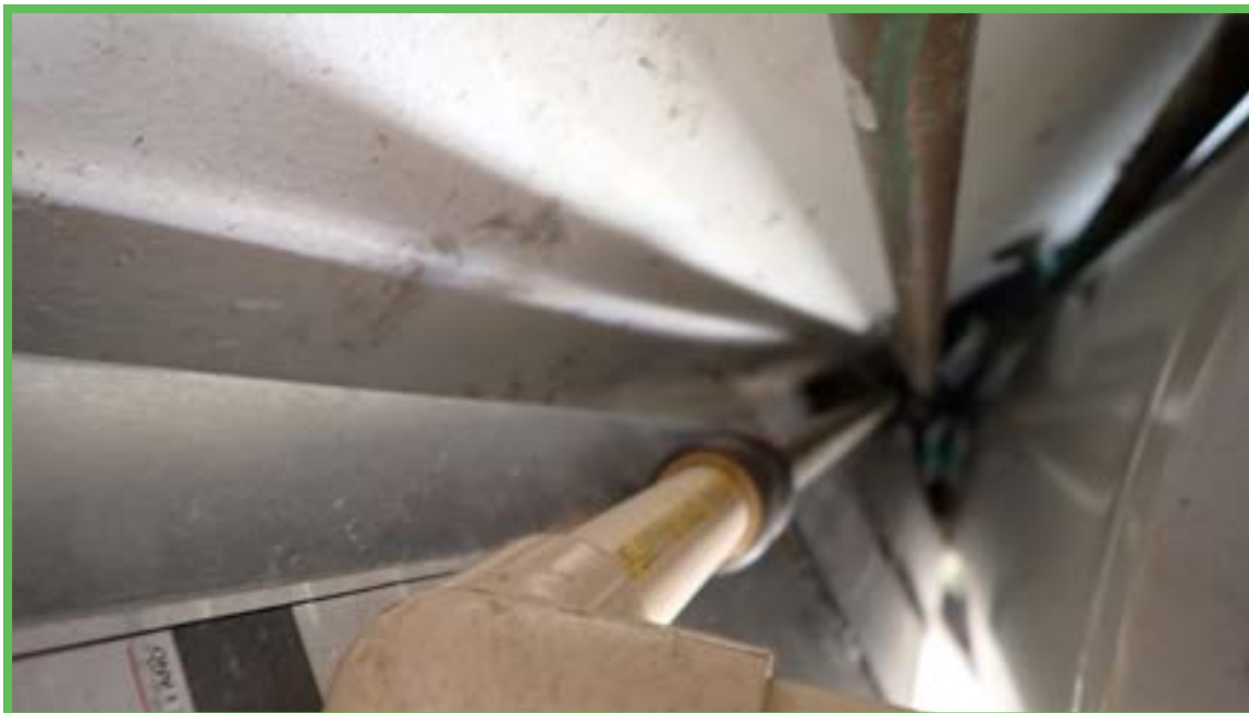
TPR Discharge Pipe
