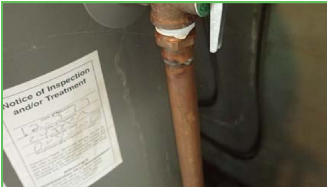
TPR Discharge Pipe
