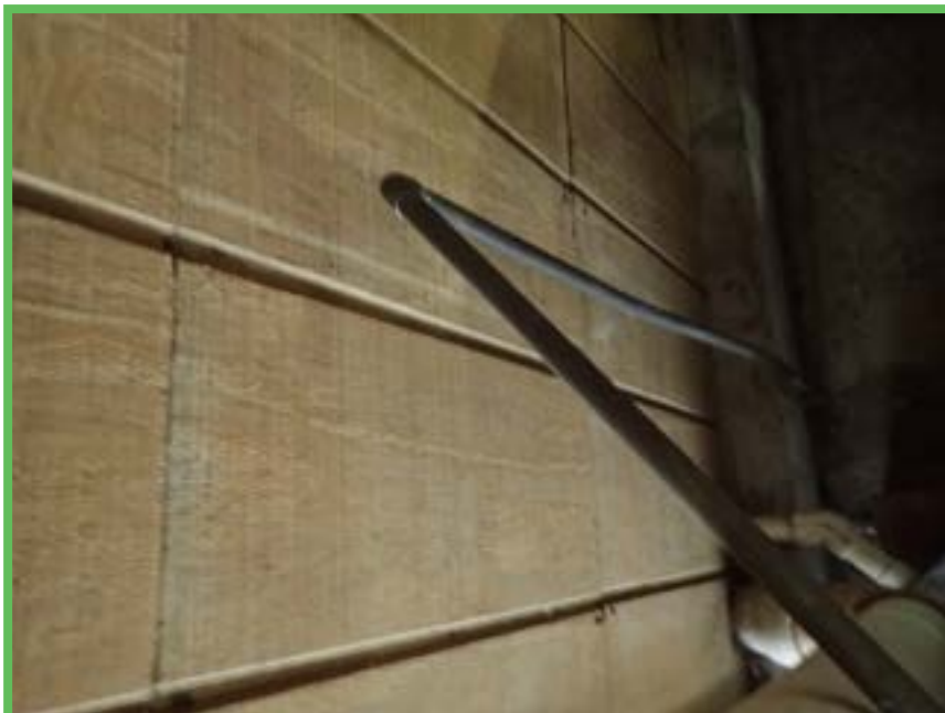
TPR Discharge Pipe
