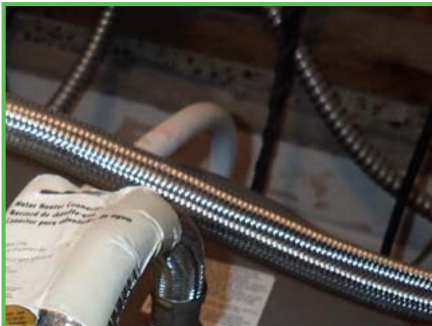
TPR Discharge Pipe
